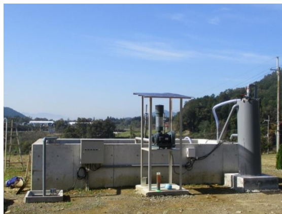
完成した汚水処理施設
