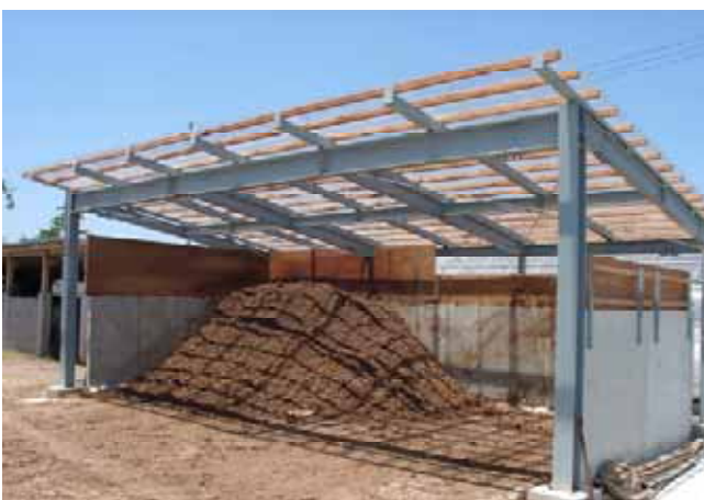
写真1：使用開始した低コスト堆肥化施設
