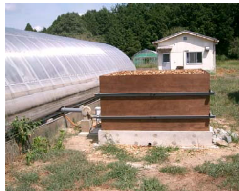
設置状況 (鶏ふん乾燥ハウスに隣接して設置)
