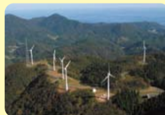
大野発電所:公営企業管理事務所の遠隔監視制御機器によって運転・監視を行っています。
