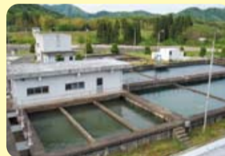
由良川から取水し、公営企業管理事務所の施設で浄化し、ポンプによって長田野・綾部両工業団地へ工業用水を供給しています。
