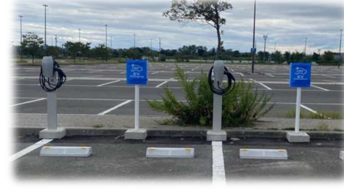
新潟県所有の施設に テスラのチャージングスポットに並列して テスラ製の高出力な普通充電設備を導入 弊社のアプリが利用できます。
