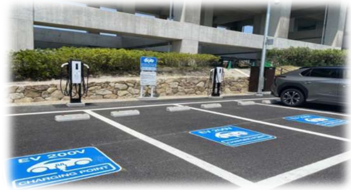
愛知県所有の施設で来訪者用の駐車場 に充電設備を導入
