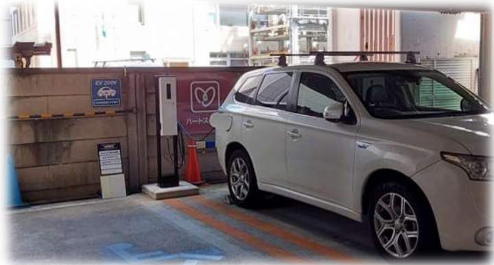
区役所の来訪者用の駐車場に 充電設備を導入
