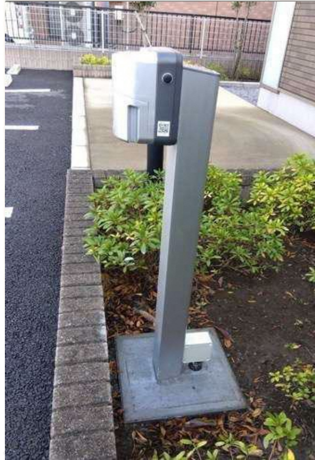
EV充電器 屋外
