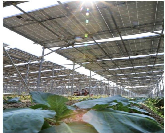
図2 亀岡市で実施されるソーラーシェアリング（538kW）
