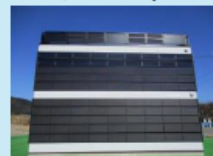
ビル壁面に太陽光パネルを設置した例 (出典: NEDO)
