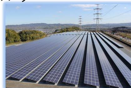
けいはんな太陽光発電所 (株)関電エネルギーソリューションが建設・運営)
