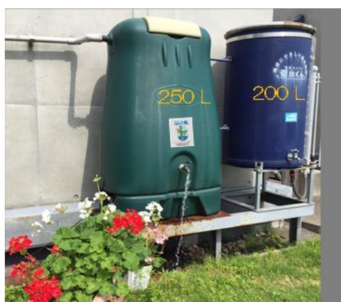
雨水貯留施設（府庁 2 号館屋上）
