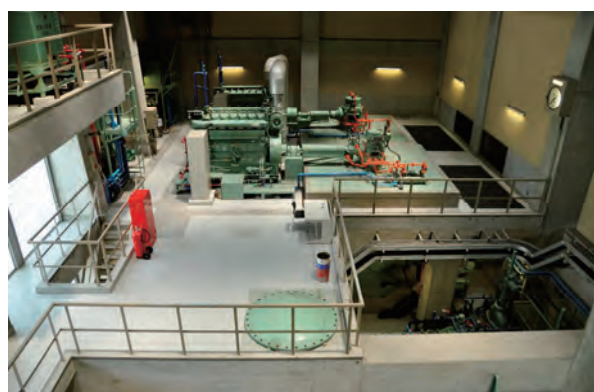
大山崎町 下植野排水ポンプ場内部
