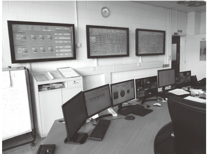
コントロールルームで24時間管理
