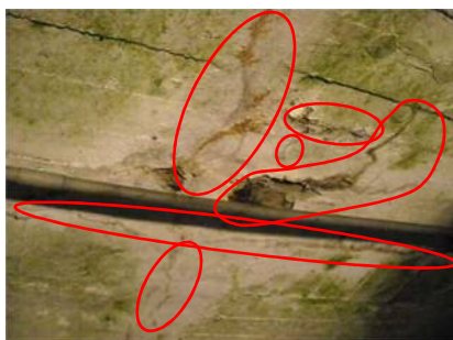
写真-B トンネル側面のクラック
