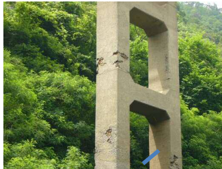
写真-K 橋脚の損傷状況(肱谷橋)
