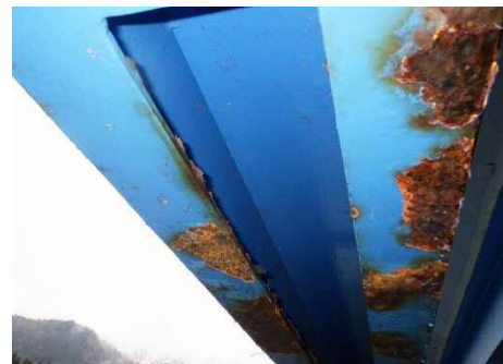
写真-I 部材の損傷状況(音海橋)
