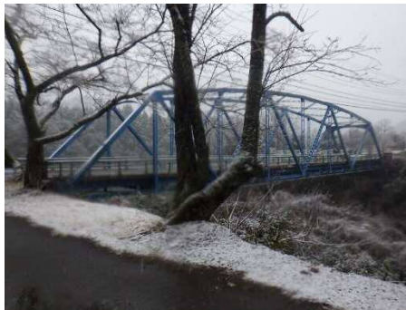
写真-H 音海橋の状況
