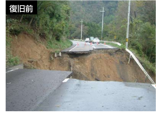
崩壊した国道173号(綾部市)
