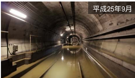
安祥寺川の溢水による 京阪京津線の浸水状況(京都市山科区)
