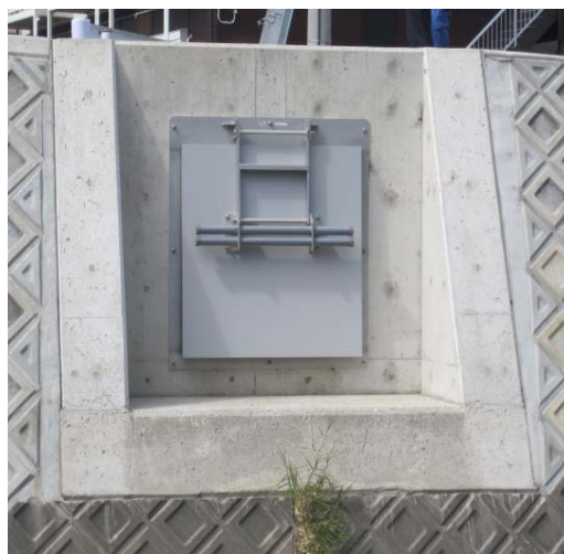
フラップゲート設置の事例
