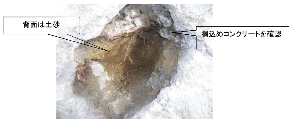
図- 4.10 護岸背面の状況 (No.26-2)
