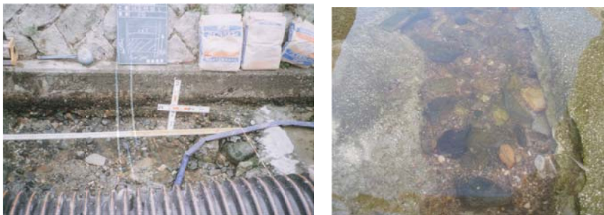
図- 4.15 平成 17 年度補修工事時の施工前河床(左)、平成 24 年 11 月現地調査での破損河床(右)
