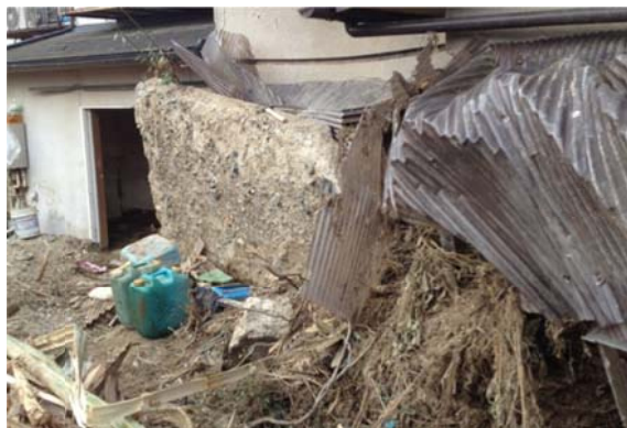
図- 4.17 欠壊箇所左岸の住宅に張り付いたコンクリート片
