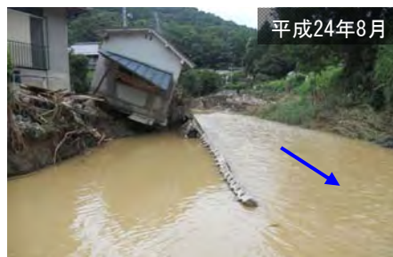
志津川の河岸欠壊(宇治市志津川)
