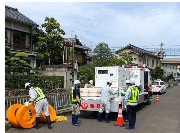
排水ポンプ車
