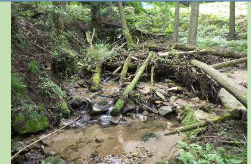
危険木の撤去(実施前)
