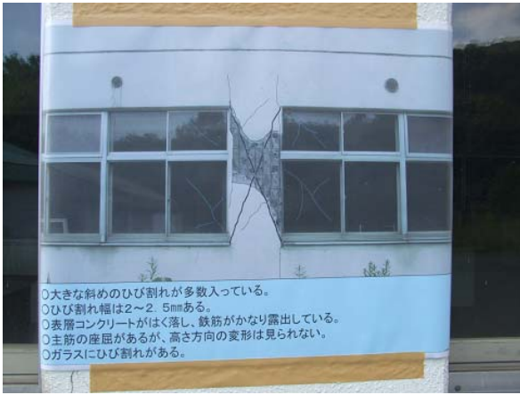
<被害状況を示す写真>
