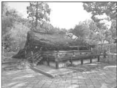
↑平野神社拝殿倒壊（府指定建造物）
