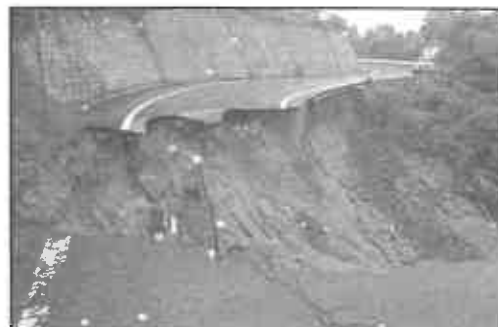
↑舞鶴宮津線（宮津市皆原）の路肩欠壊
