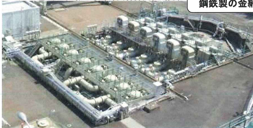
〔竜巻飛来物対策設備設置前〕
