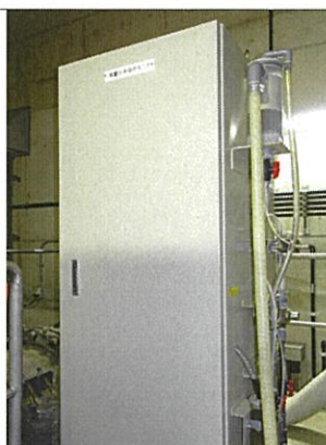
木津浄水場油臭センサー
