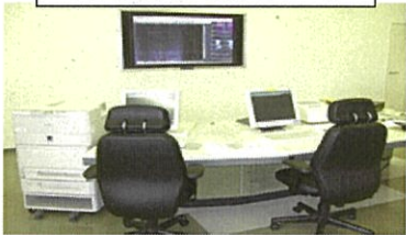
中央監視室(新浄水場)
