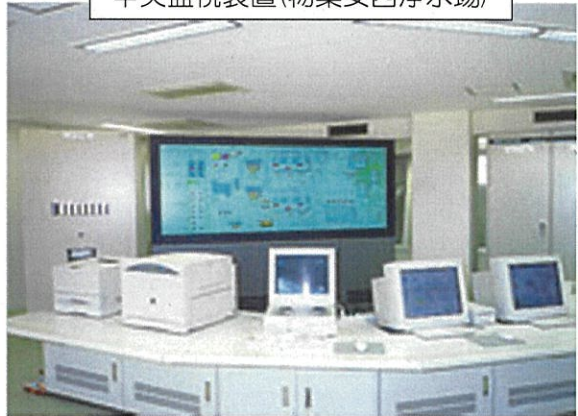
中央監視装置(物集女西浄水場)
