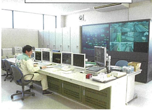
浄水場監視室(美濃山浄水場)
