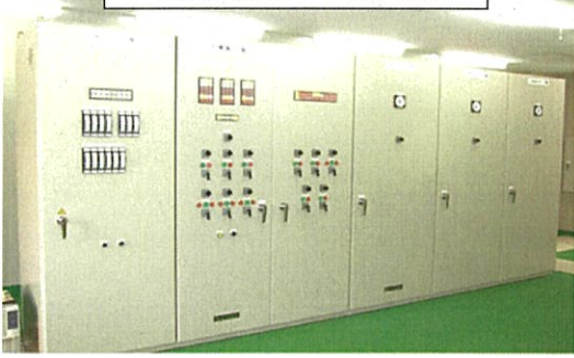
電気室(宮ノ口受水場)
