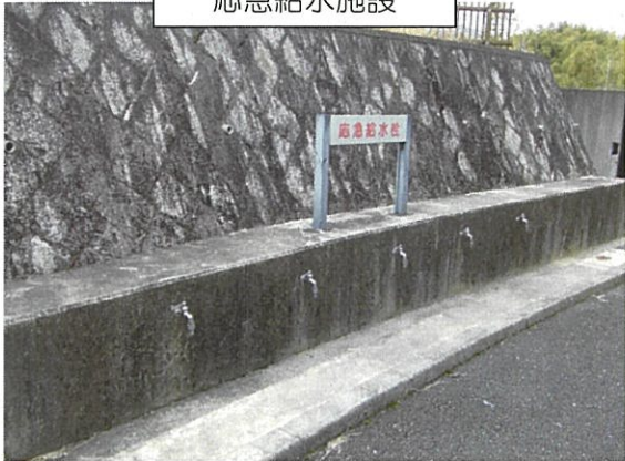
応急給水施設
