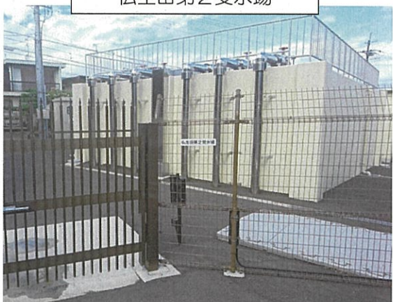
仏生田第2 受水場
