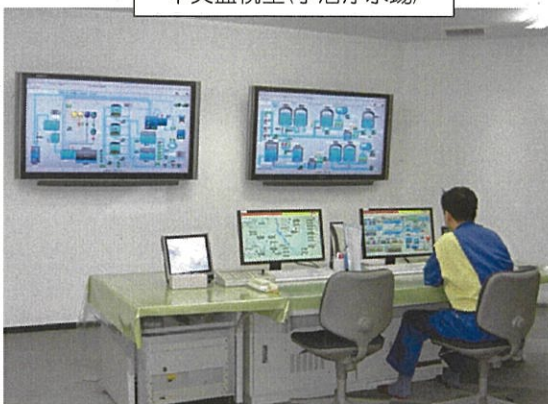
中央監視室(宇治浄水場)
