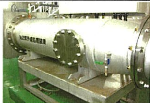
紫外線処理室(新浄水場)
