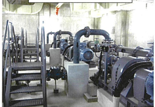
ポンプ室(宮ノ口受水場)
