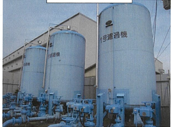
ろ過機(佐古浄水場)
