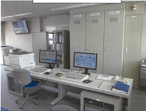
中央管理室(佐古浄水場)
