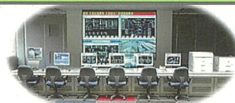
広域浄水センター(水運用)
