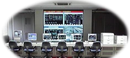
広域浄水センター(水運用)
