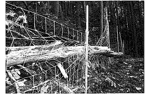
《折角の防護柵が倒木で大破！台風や大風のあとは、特に注意して点検を》
