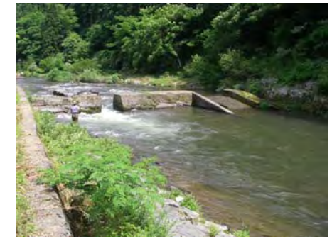
⑧松原堰堤 (現在は使われていないと思われる堰で破損している。スリット部の流速が速く、下流側に魚が滞留している。既設魚道に水は流れていない。)
