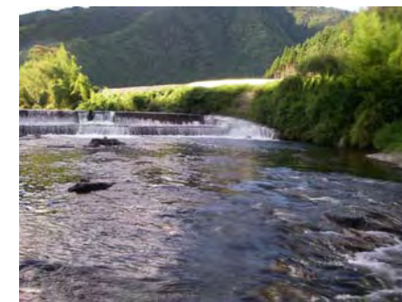
⑥南堰堤 (堰本体および水叩きに大きな段差があり、遡上不可である。既設魚道は機能していない。)
