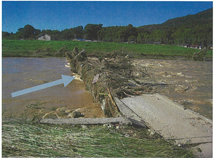
保津小橋 (平成25年台風18号被害状況)
