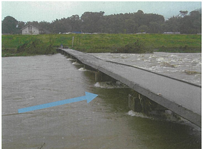
保津小橋 (平成25年18号台風被害状況)
