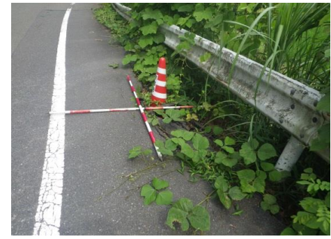
路肩クラック沈下
