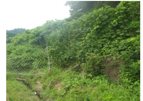
小規模崩壊状況
