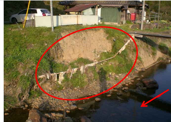
崩壊時の状況
