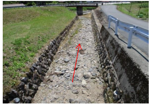
市道橋下流側 流路が土砂で完全に埋塞されている
