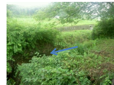
提案箇所(下流) 余水吐周辺
