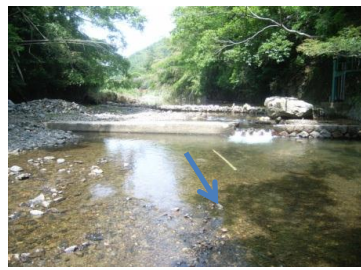
提案箇所上流端の土砂堆積
