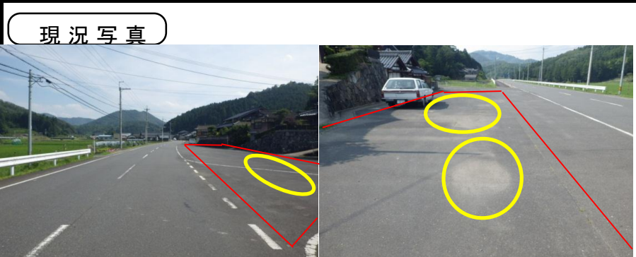
①舗装の沈下による水たまり発生箇所
