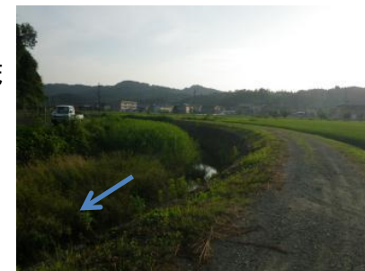
中流部 土砂の堆積、草の繁茂
