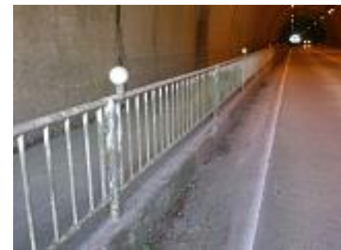
デリネーター 転落防止柵状況
