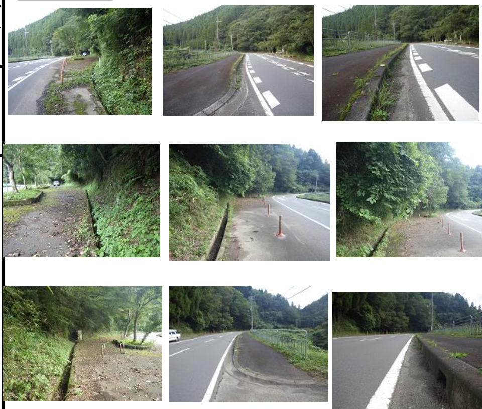
路面・側溝・ガッター・木枝の張りだし状況
