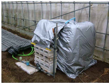
給液装置 (タンク、ポンプ、電磁弁など)
