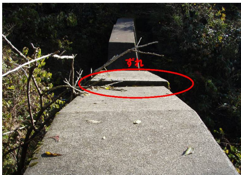
図 1.16 対策施設の変状の事例
