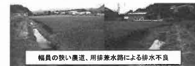
幅員の狭い農道、用排水水路による排水不良
