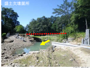
盛土欠壊箇所
