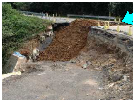
【福知山市】(国道への土砂流入)
