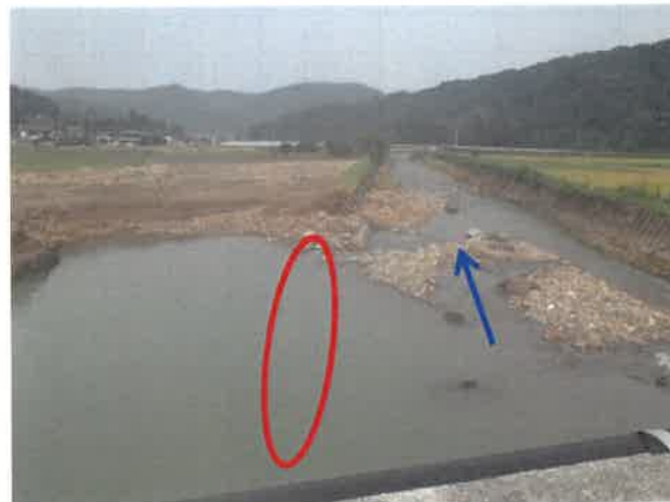
【場所】伊根町 二級河川 筒川 【被災状況】河岸浸食 延長1,410m (14箇所22工区) 【復旧内容】ブロック積工 566,500千円
