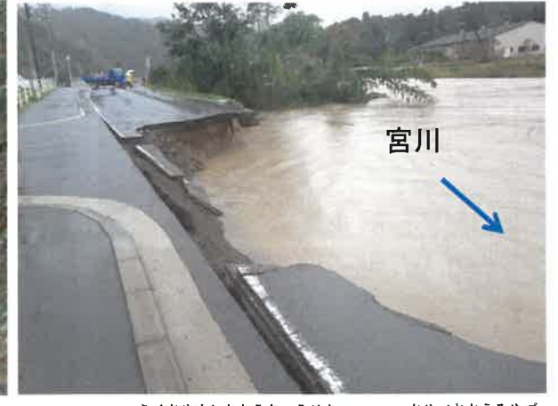
【場所】福知山市大江町関 (主) 綾部大江宮津線 【被災状況】道路陥没 延長40m 【復旧内容】大型ブロック工 40,000千円
