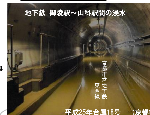
平成25年の浸水被害
