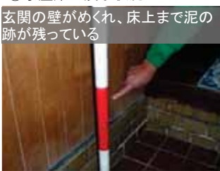
③家屋床上浸水状況
