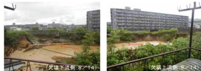
欠壊箇所図および被災直後写真
