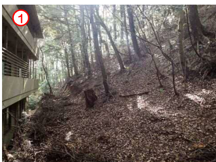
保全対象施設と斜面の崩壊状況
