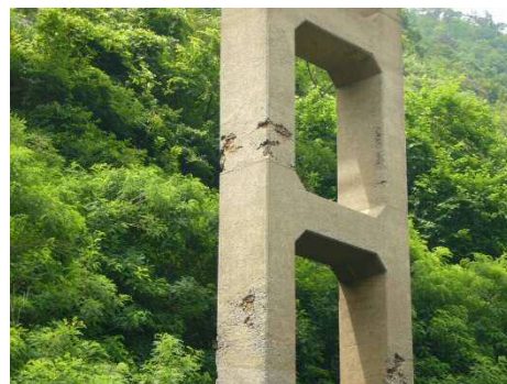
【写真-I 橋脚の損傷状況】
