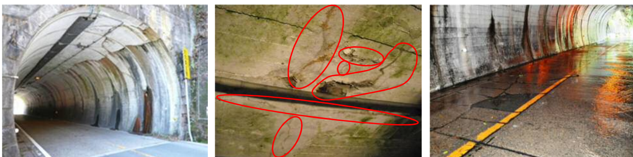
【写真-A トンネルの状況】 【写真-B トンネル側面のクラック】 【写真-C 漏水により冠水状態 (H25.9台風18号)】
